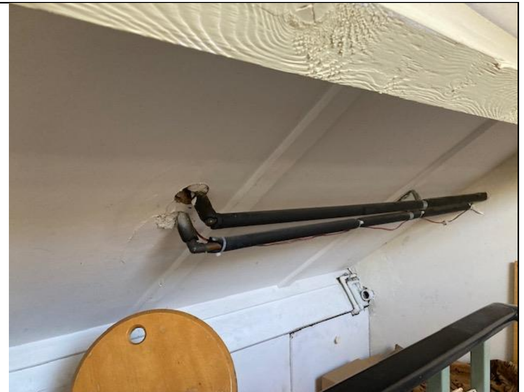
Foto 2: Evenzo dak op de overloop met de leidingen naar de zonneboiler.
